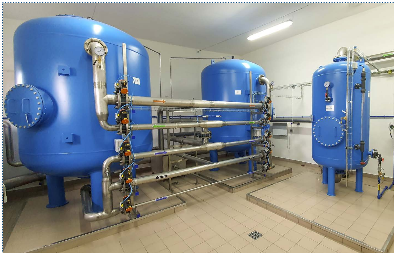
Fot. 2. Modernizacja stacji uzdatniania wody realizowana przez firmę „Centrum Badawczo-Wdrożeniowe UNITEX Sp. z o. o.” z zastosowaniem złożeń katalitycznych – Masy Katalitycznej G-1 „DemanTEX”
